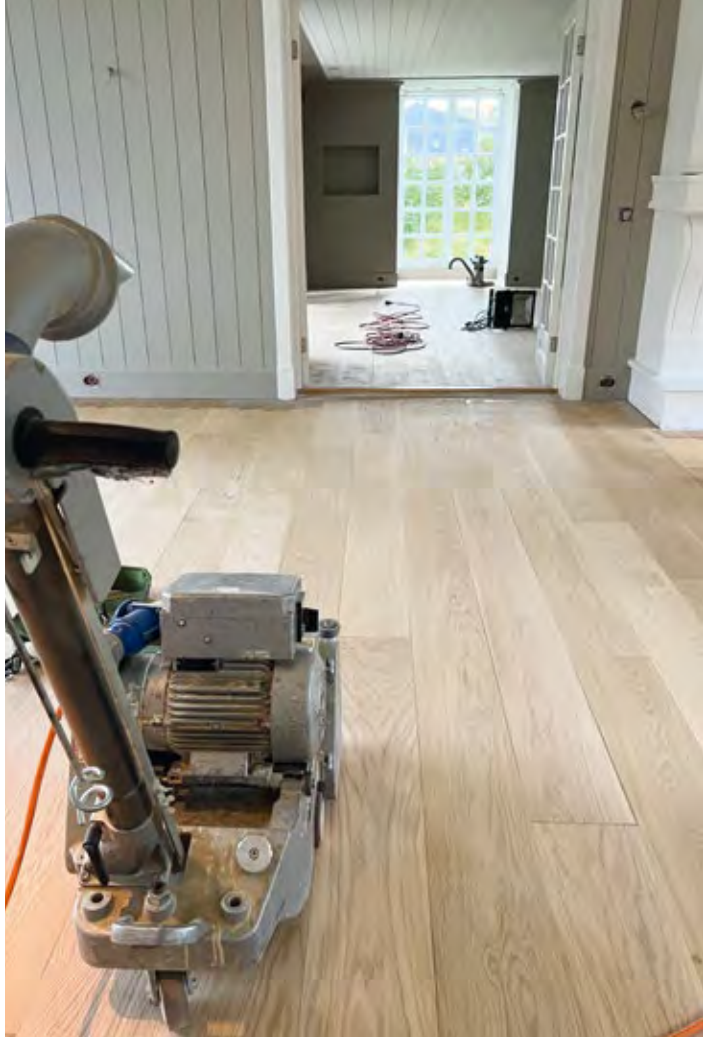
▲ Sliping av gulv.
